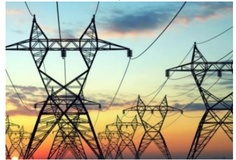
Fig. 6.21. Rrjeti për shpërndarje të energjisë elektrike.
